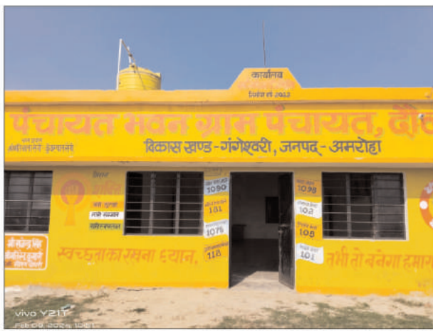
10:52 मिनट पर ग्राम पंचायत दौलतापुर कला के पंचायत भवन पर मैन गेट का ताला खुला हुआ।
